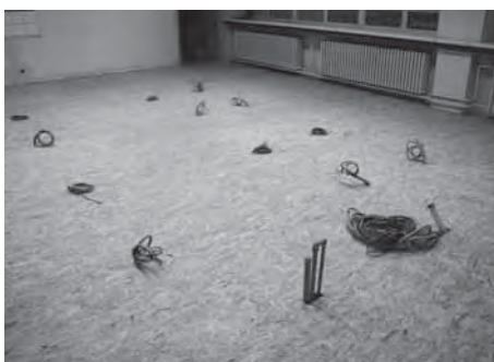
Elektrorozvody do lavic
